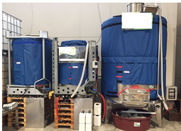
Produzione di compost Composts production
