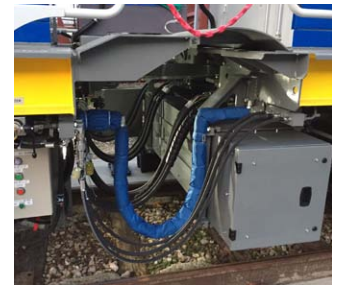
Uso su tubazioni Pipes application
